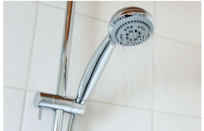
Sanitärfugen werden auch durch unterschiedliche Wassertemperaturen besonders belastet.
